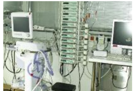
Unterschiedlichste Geräte müssen integriert werden.
